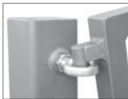
obere Torlagerung, Zustand: geöffnet
