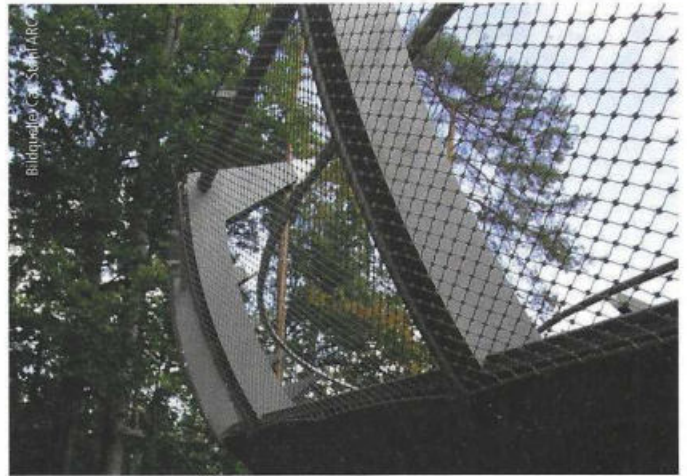
Sowohl die besondere Formgebung der Holme als auch das engmaschige Gitternetz verhindern an diesem Brückengeländer sehr wirksam das Überklettern.
